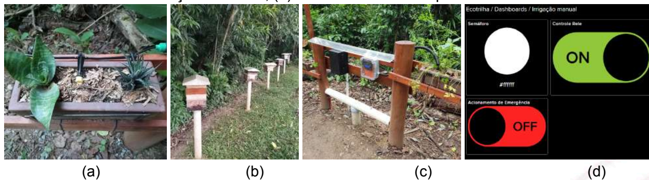
Figura 1 - (a) Plantas com sistema de irrigação instalado; (b) Caixas de ASF adquiridas; (c) Sistema de automação instalado; (d) Interface do Adafruit para acionamento remoto.
